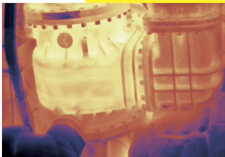
Thermografische Untersuchung einer Brennkammer
